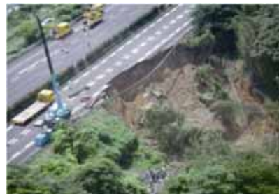
東名高速牧之原の盛土崩壊
