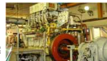
排ガス後処理装置
