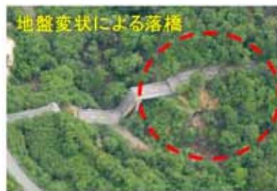
祭時大橋の落橋
