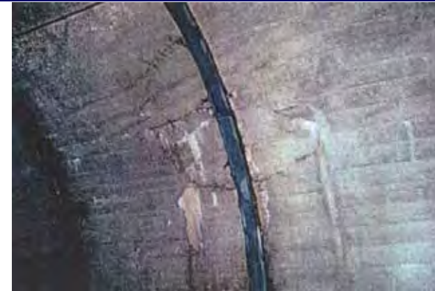
【トンネル覆工コンクリート剥離】 出典：国土交通省資料
