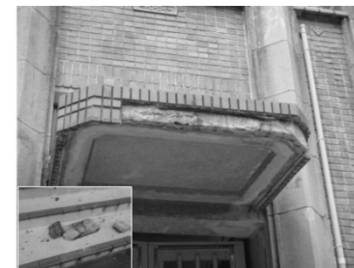
▲外壁タイルの剥落
