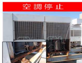
■空調機 経年23年 内部部品が腐食したため、温度調節ができない状態。
