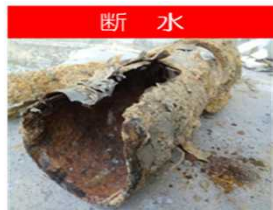
■排水管 経年36年 劣化により腐食、破損し、排水が漏洩。
