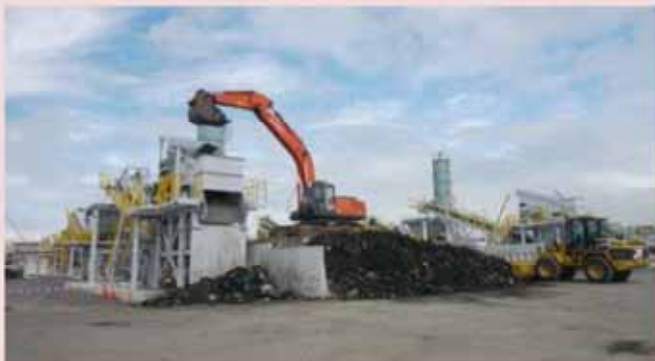
土質改質設備
