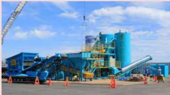
焼却主灰の再資源化プラント
