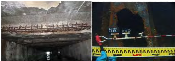
コンクリートの陥没鋼矢板の欠損等の事例
