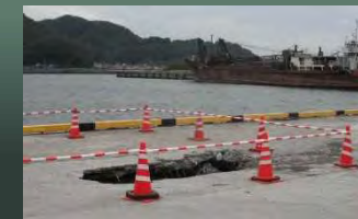
エプロン陥没事例
