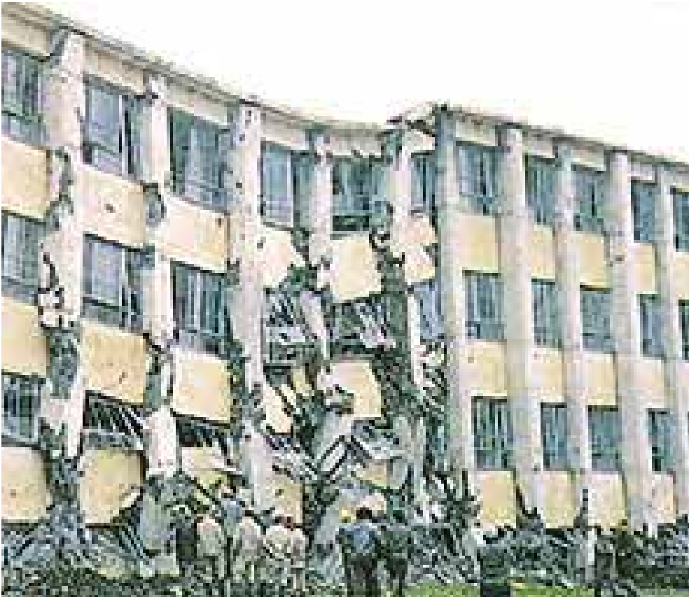
十勝沖地震（1968） 〔短柱のせん断破壊〕
