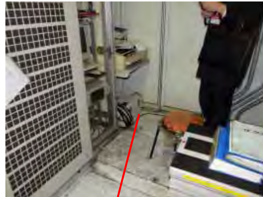
クレーン上強震計
