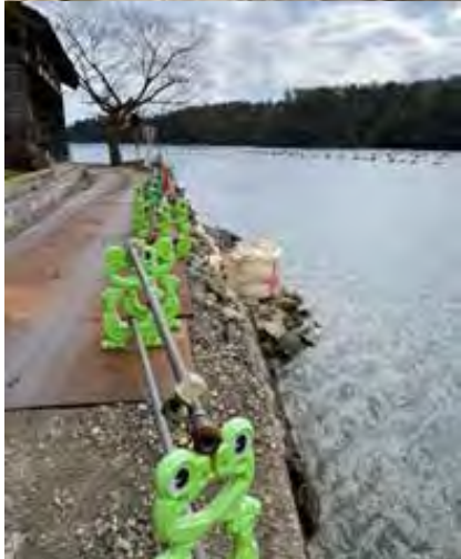
道路の被害状況（啓開済）
