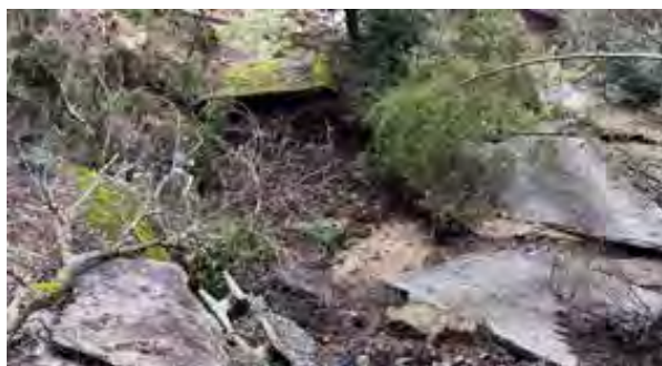
道路の被害状況
