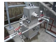
湯煙発電(二相タービン) (ターボブレード)
