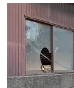
窓が割れた管理不全空家
