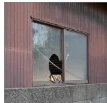
窓が割れた管理不全空家
