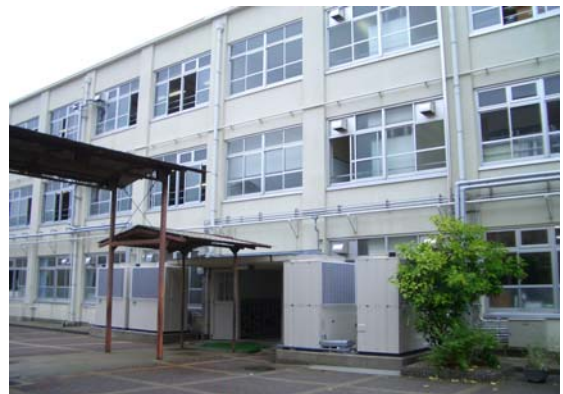
空調設備の室外機（写真中央部）
