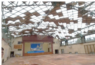
台風で屋根が消失した体育館
