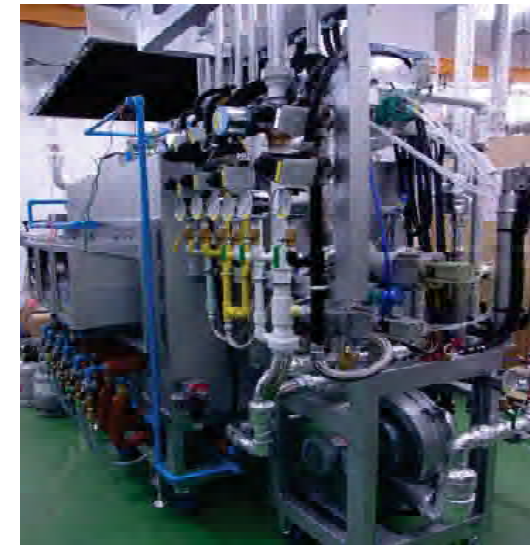
高温酸素燃焼炉 (NEDO事業開発中)
