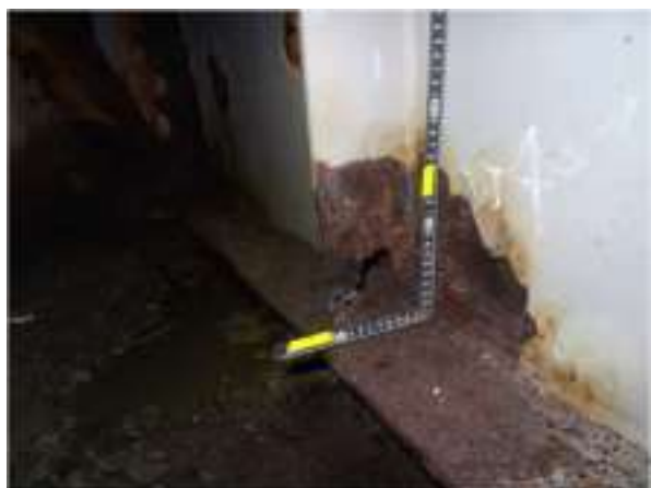
国管理 主桁腐食・欠損
