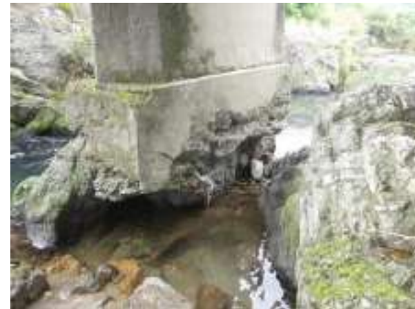
地方自治体管理 橋脚洗掘
