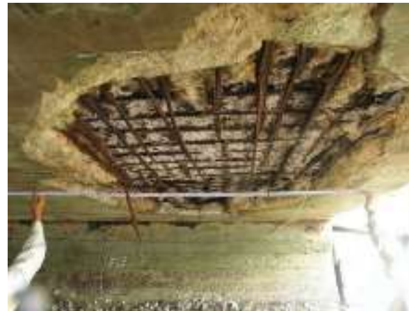
地方自治体管理 床版鉄筋露出
