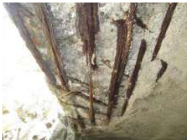
国管理 床版鉄筋露出 ※床版:橋の裏側
