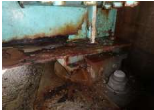
地方自治体管理 主桁腐食
