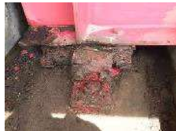
地方自治体管理 支承腐食
