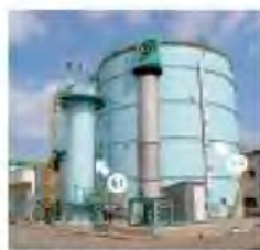
バイオガスを調製する①精製塔と②ガスホルダー
