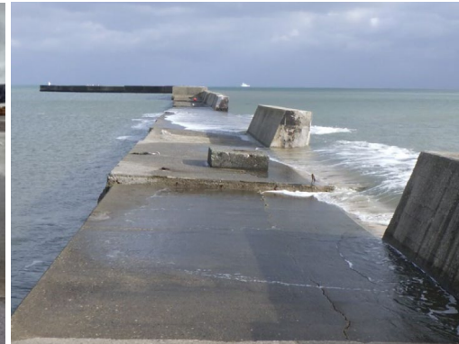
飯田港における津波被害状況
