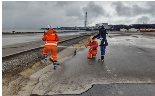
七尾港における被災状況調査
