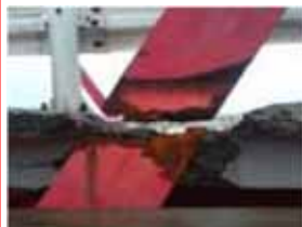
木曽川大橋のトラスの破断
