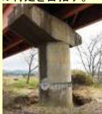
＜通行に影響を及ぼした橋梁被害＞
