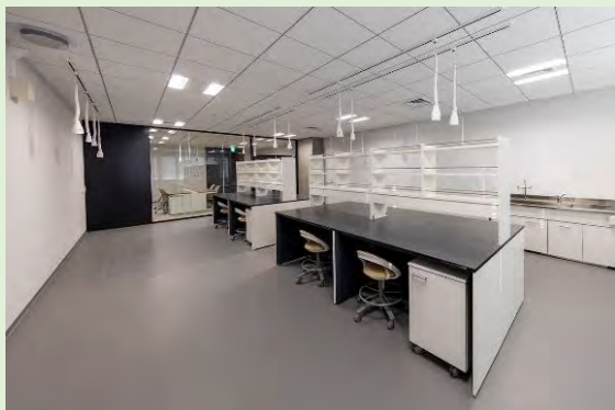
内装仕上、水廻り、実験台まで 作り込まれたレンタルラボの仕様（インキュベーション施設向け）機器のみの用意で運用可能
