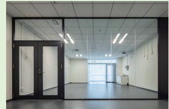
内装仕上及び水廻り（流し台）まで 一般的なレンタルラボの仕様、実験台と機器を用意すれば運用可能（排気は接続口まで用意）
