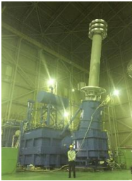
超高電圧用絶縁変圧器
