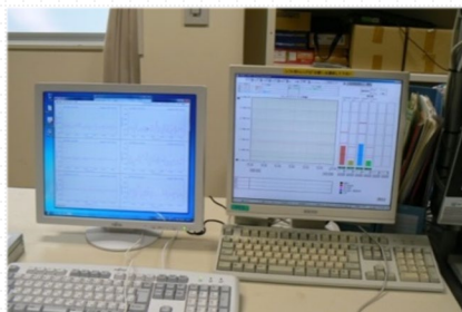
集中監視システム
