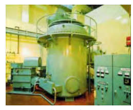
電子線照射設備
