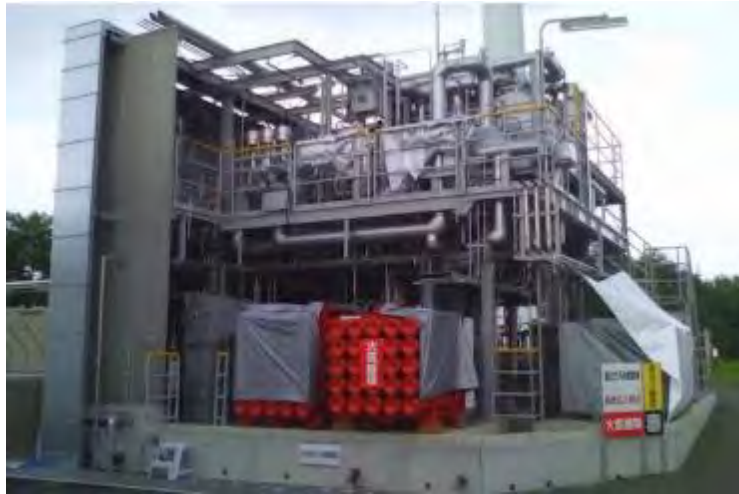
図 3-48 アンモニア合成実証試験装置
