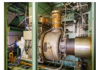
アンモニア専焼2MW級ガスタービン 4
