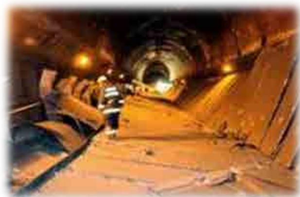
笹子トンネル事故 (2012年12月)
