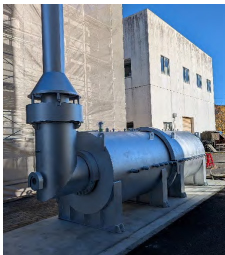
図 B1-5 入熱量 200 kW の燃焼試験炉(岐阜大学に設置)
