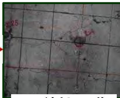
ひび割れ画像
