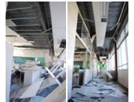
茨城大学(天井材の落下等)
