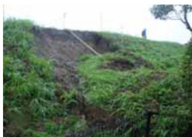
洪水時のり面崩壊の事例
