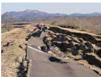
堤体の液状化による代表的な被災事例
