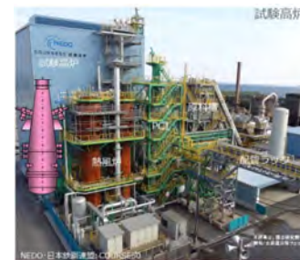
COURSE50試験高炉
