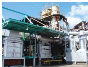
電池の無害化 処理工程
