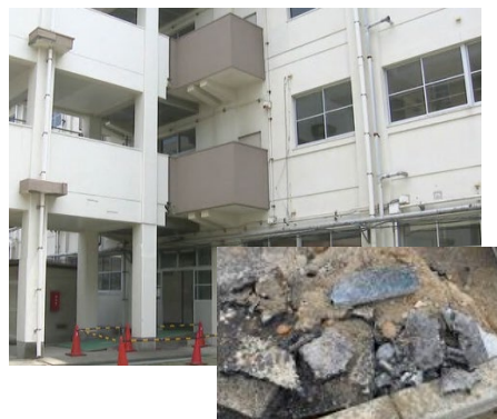
外壁コンクリート 片の落下事故
