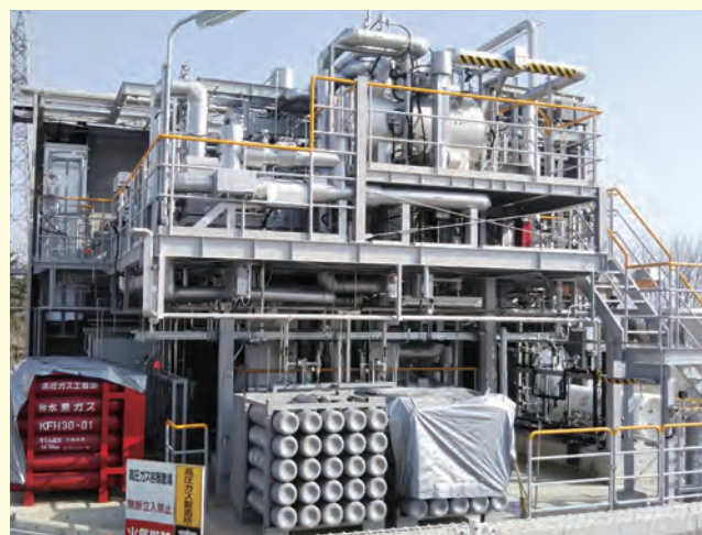
●アンモニア製造パイロット設備の外観
