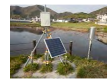
水位計と雨量計によるリアルタイム監視
