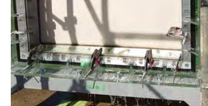
膜固定材から漏水
