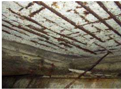
塩害により鉄筋がむき出し
