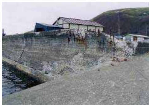
老朽化した海岸堤防
