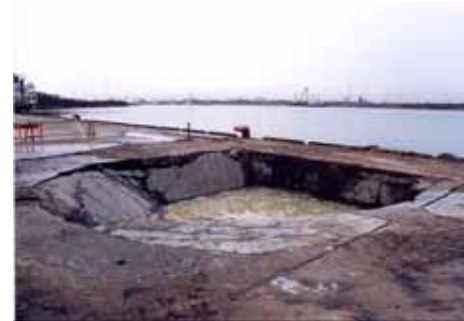
エプロン部分の陥没
