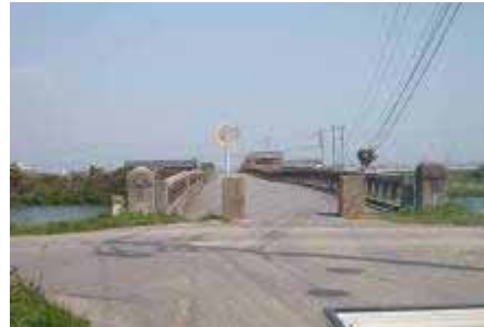
老朽化による重量規制
