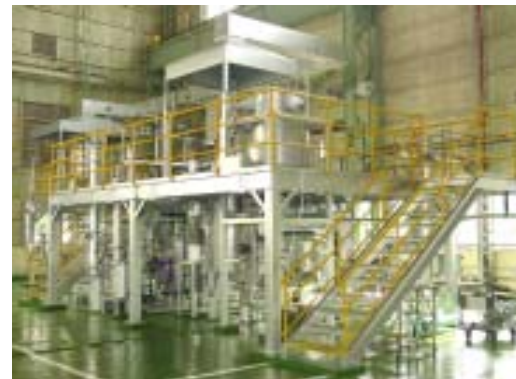
ガス化メタノール変換実証プラント 「農林グリーン1号機」
