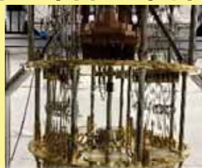
冷凍機内部配線
