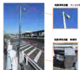
路側無線装置
