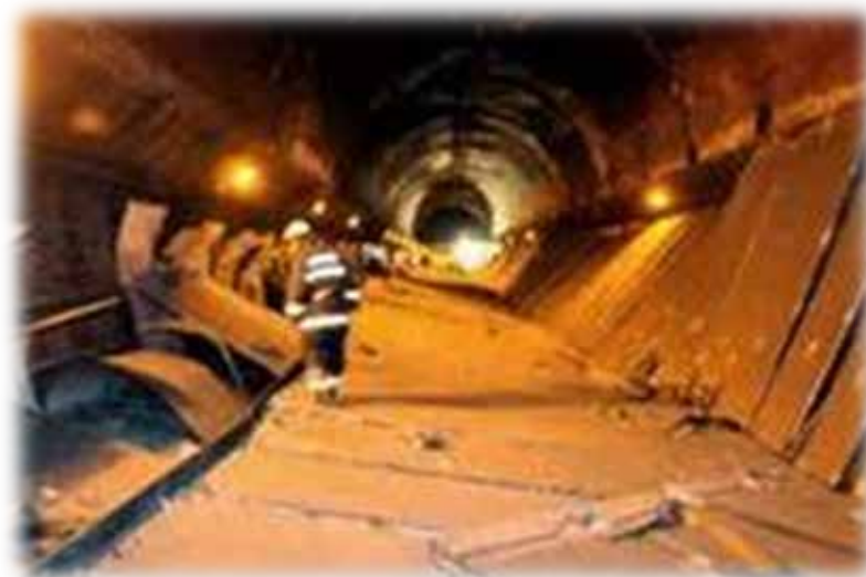
笹子トンネル事故(2012年12月)
