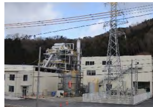
バイオマス発電所
