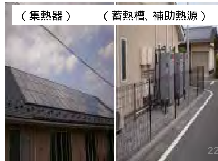
図3 老人ホームへの設置例(長野県)
