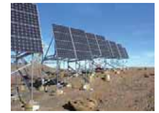
55kW分パネル
