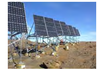
55kW分パネル
