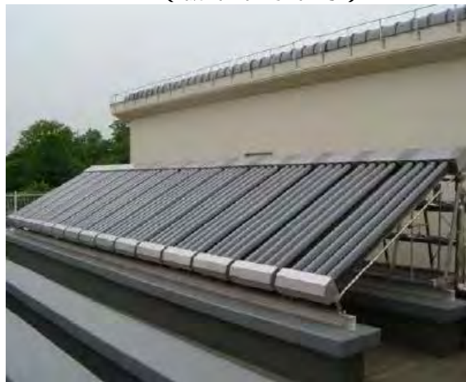
図2 小学校の給食室への設置例(栃木県野木町)
