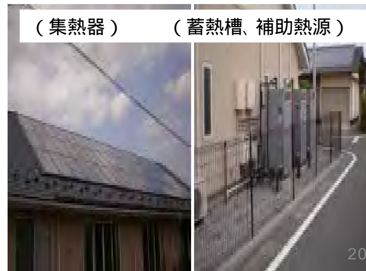
図3 老人ホームへの設置例(長野県)
