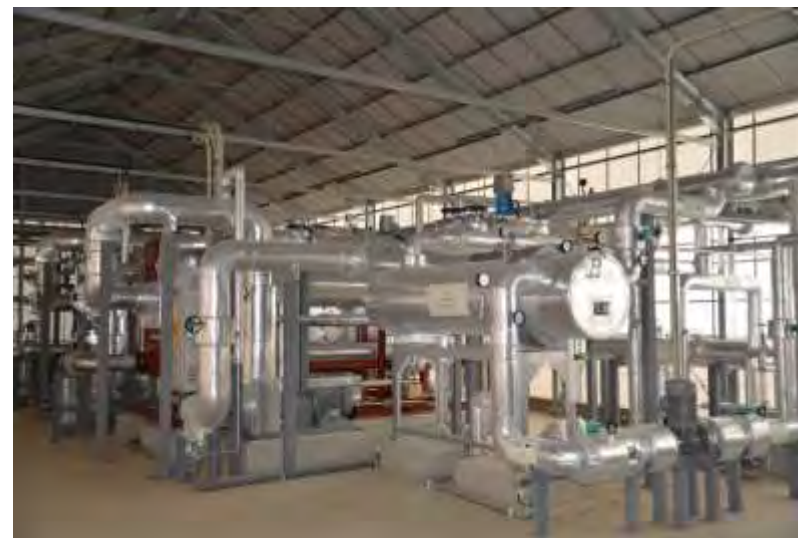
・国内初の地域バイオマス由来の温室内冷暖房システム
