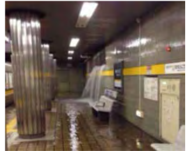
大雨の影響で冠水する↑名古屋の地下鉄駅
