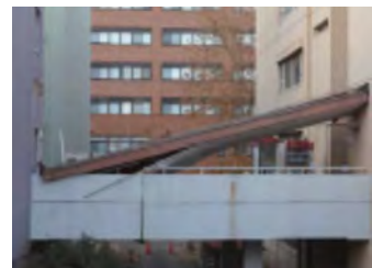
連絡通路の屋根崩落
