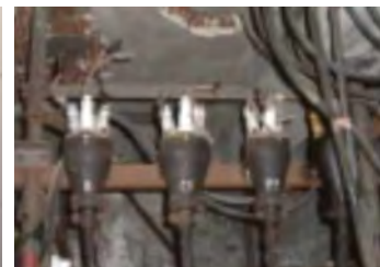
電気ケーブルの劣化
